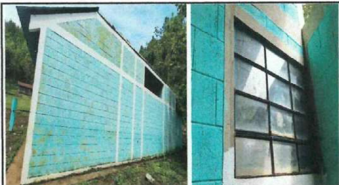
Foto 3: se nesecita aplicar pintura en muros interiores y exteriores del centro educativo
