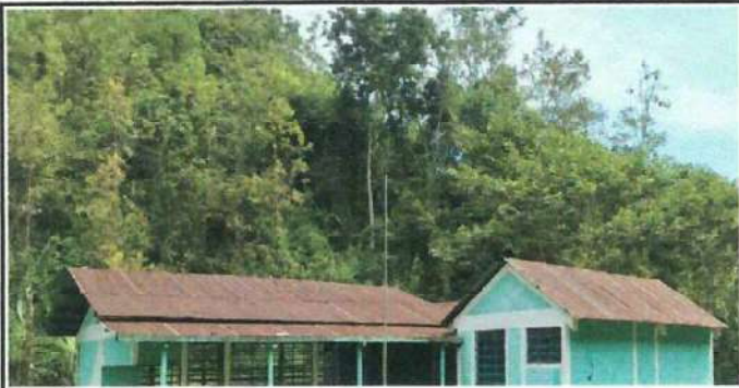
Foto1: se prioriza efectuar cambio de laminas a toda la estructura de la escuela así como canales y bajadas de agua pluviales
